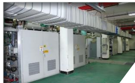
▲ Chlor-Alkali 제조공정 전원장치
